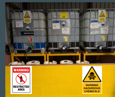
Хранение азотной кислоты
